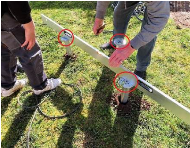
Vérification des niveaux.
